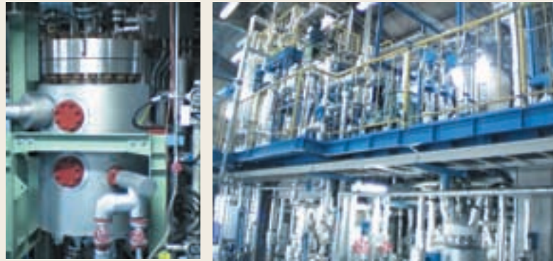
総合研究所敷地内に建設中のNHPI触媒を使ったアジピン酸製造技術パイロット設備
